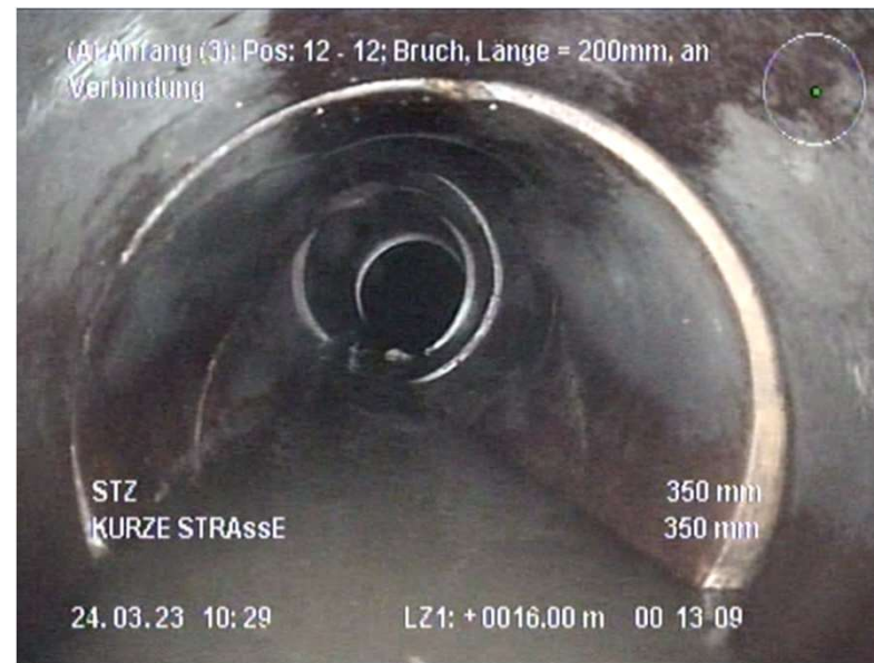
Rohrbruch und Deformation
